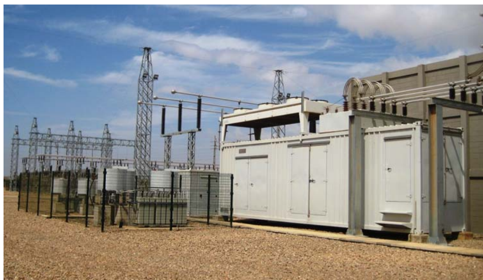
Рис.4. Общий вид регулятора УШРТ на ПС Самата
