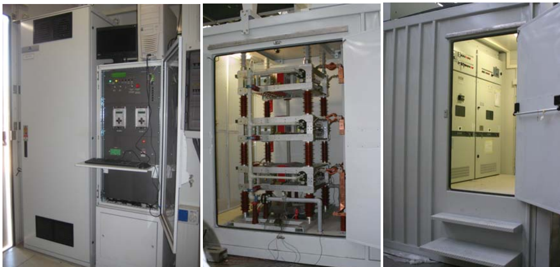
Рис.3. Отсеки контейнера: управление, вентиль, КРУ
